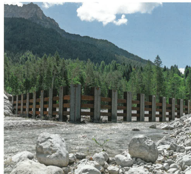
Retentionsbecken mit vorgelagertem Wildholz- und Geschiebefang in Waidring
